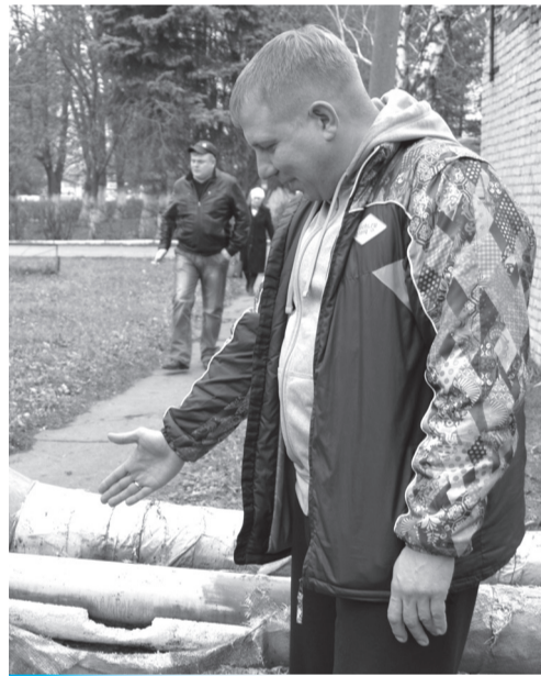
Глава Воловского района А. В. Свириносматривает тепловые сети с нарушенной изоляцией
